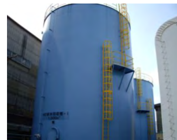
《工程排水緊急回収タンク》
