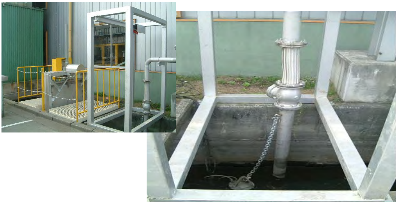
写真1. 緊急時用水門
