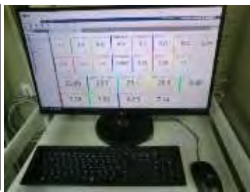
常時監視モニター
