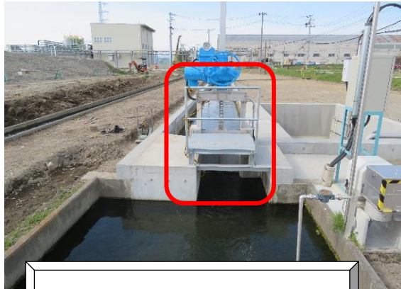
No. 3 緊急遮断弁 (最終排水口)
