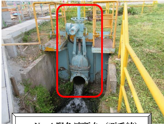
No. 4 緊急遮断弁 (西系統)
