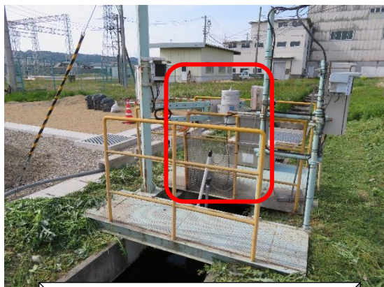
No. 4 監視機器 (西系統)
