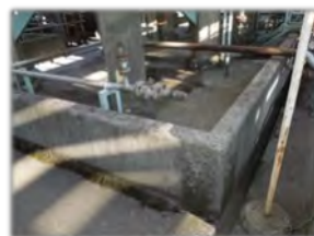
【川崎工場 防液提の様子】
