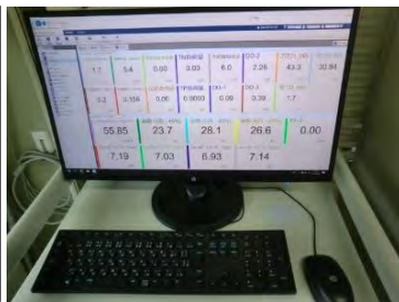
常時監視モニター
