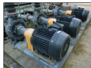
高効率モーターの冷却水ポンプ
