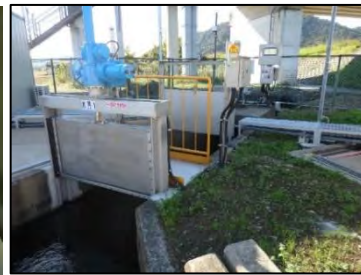
排水路の自動開閉式水門
