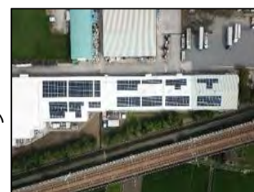
太陽光パネル
