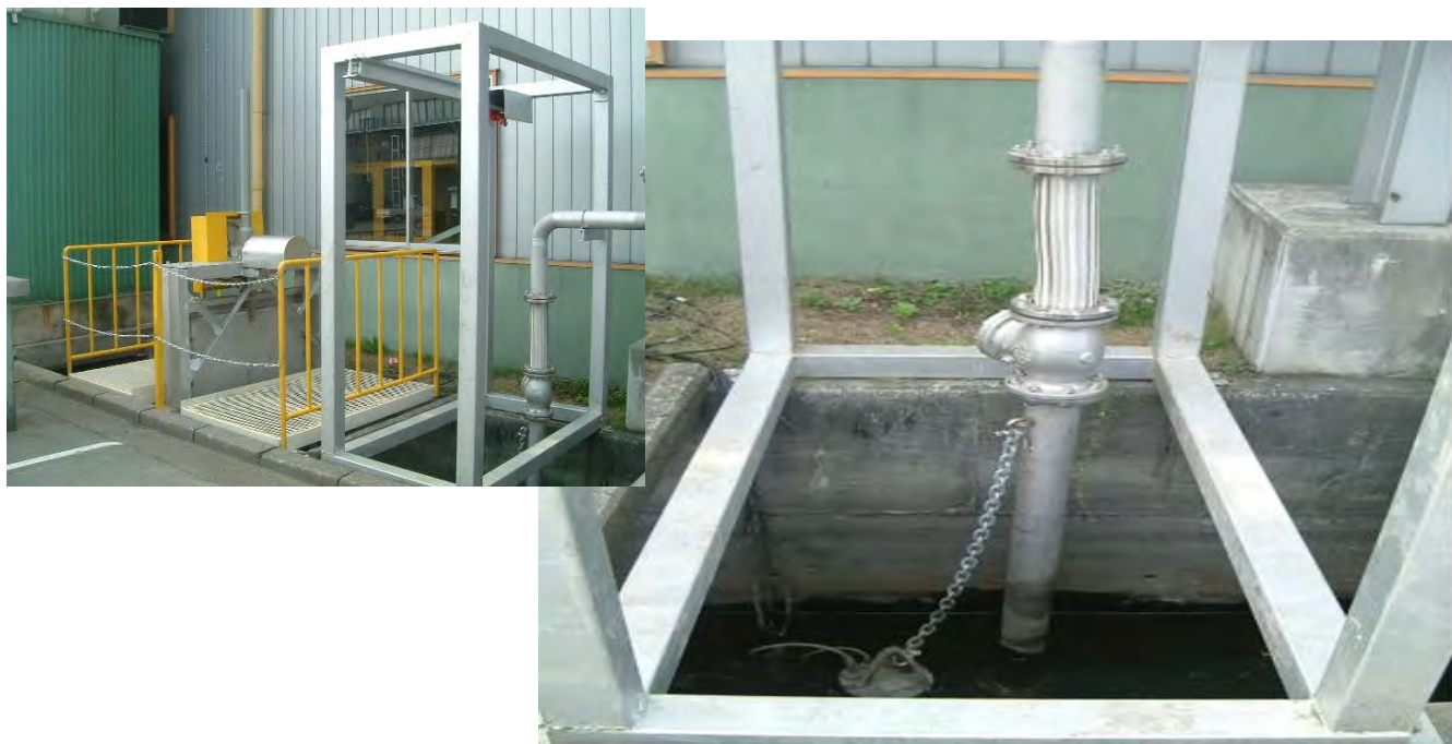
写真1. 緊急時用水門
