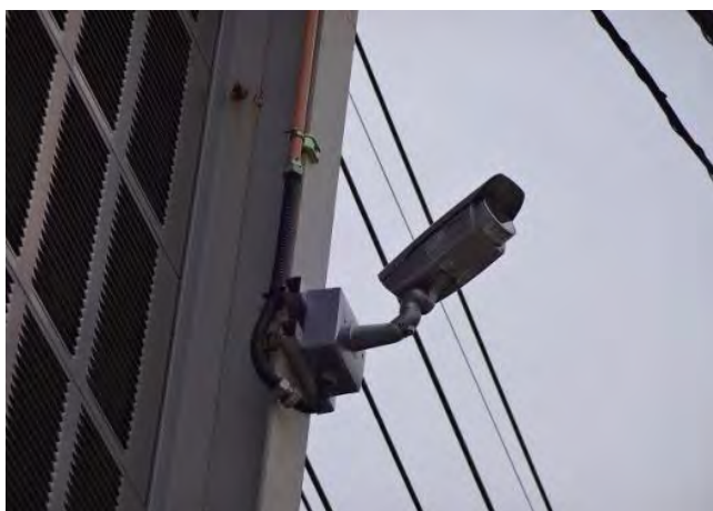
写真2. 煙監視カメラ
