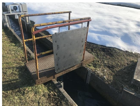
最終放流口に設置した止水板
