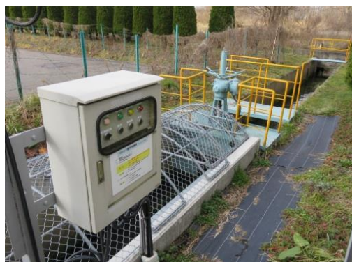
異常時緊急遮断弁(ロトルク)
