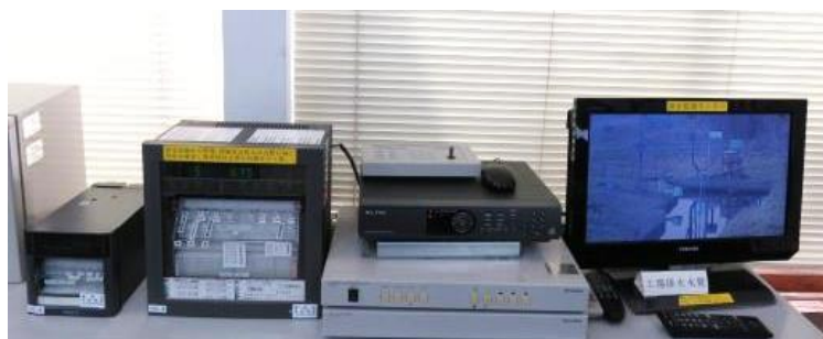
排水記録計と監視モニター
