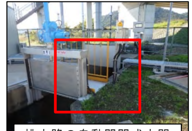
排水路の自動開閉式水門
