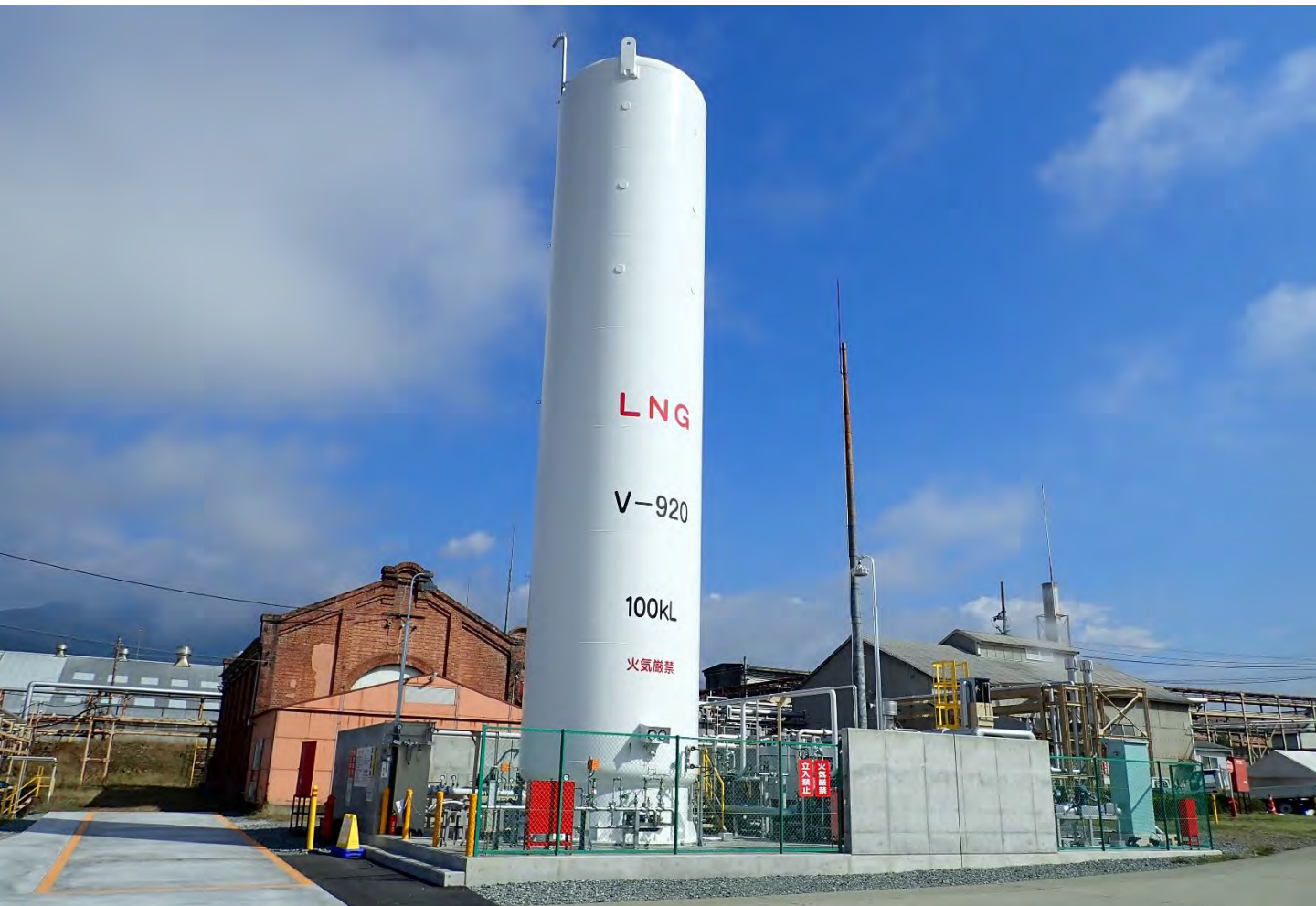
LNGサテライト設備
