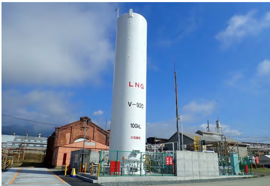
LNGサテライト全景
