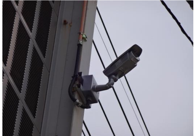
写真2. 煙監視カメラ
