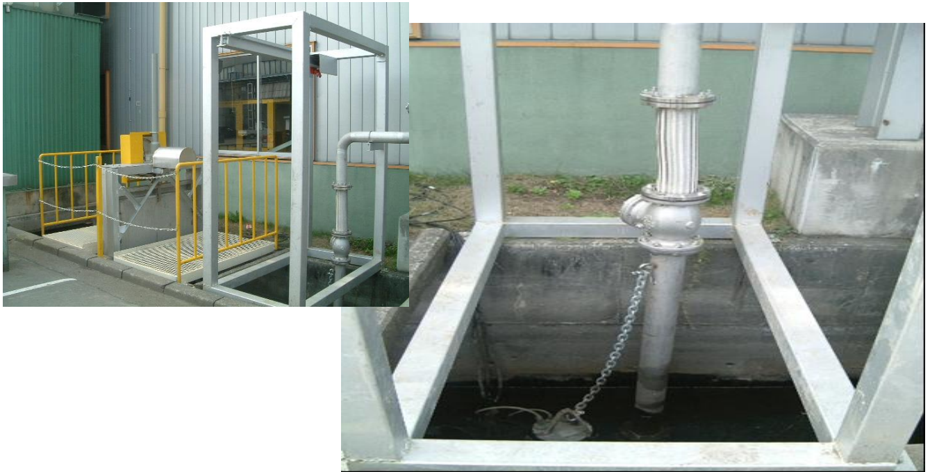
写真1. 緊急時用水門
