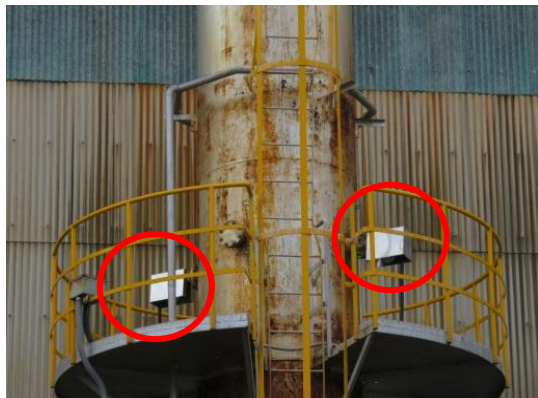
溶解炉煙突の黒煙センサー
