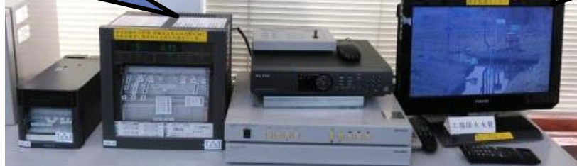
排水記録計と監視モニター
