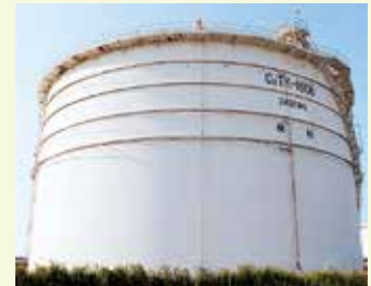
浮き屋根式ナフサタンク
