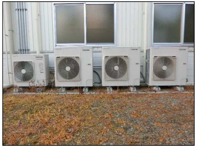
省エネルギータイプに更新したエアコン室外機
