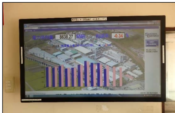
電力監視システムモニター
