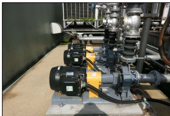
高効率モーターの冷却水ポンプ
