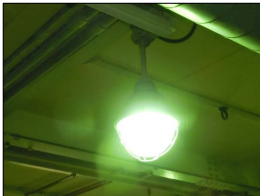
製造施設の照明（水銀灯）
