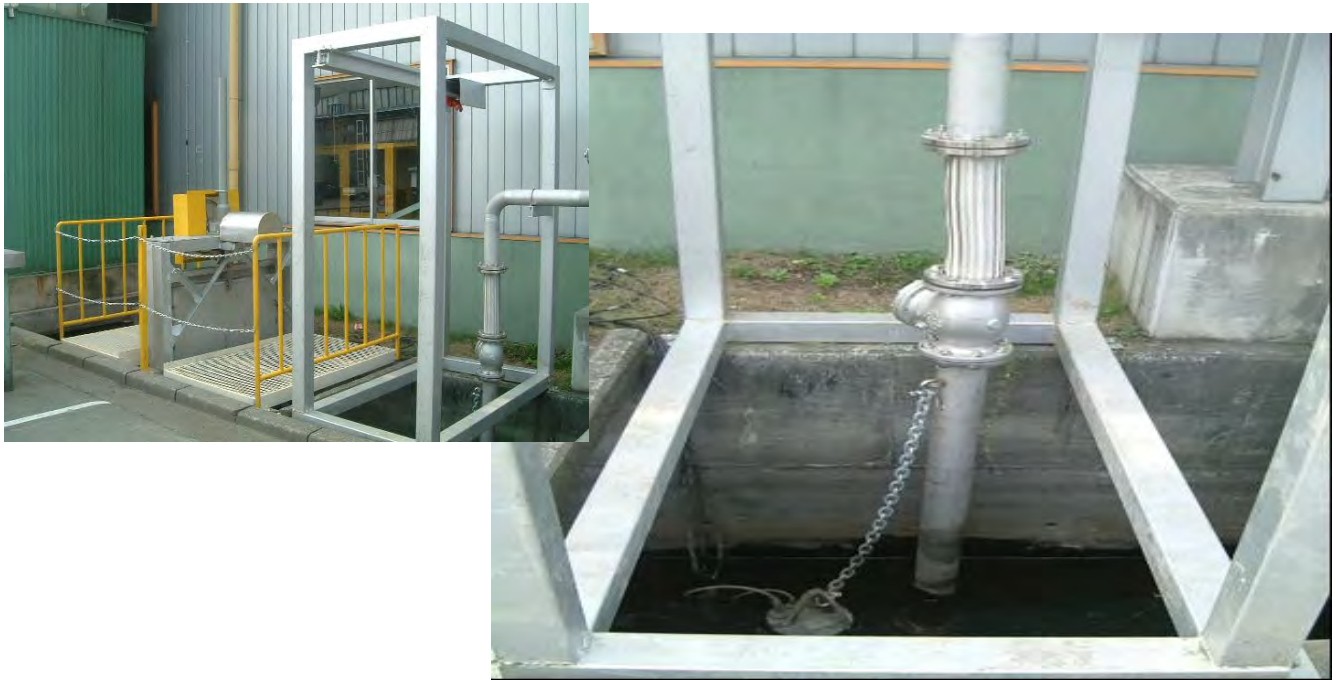
写真1. 緊急時用水門
