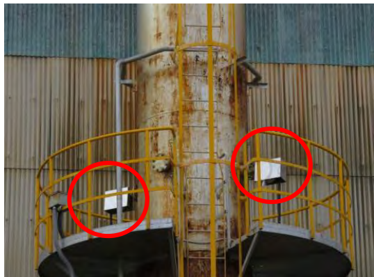
溶解炉煙突の黒煙センサー
