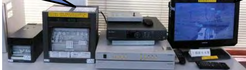
排水記録計と監視モニター
