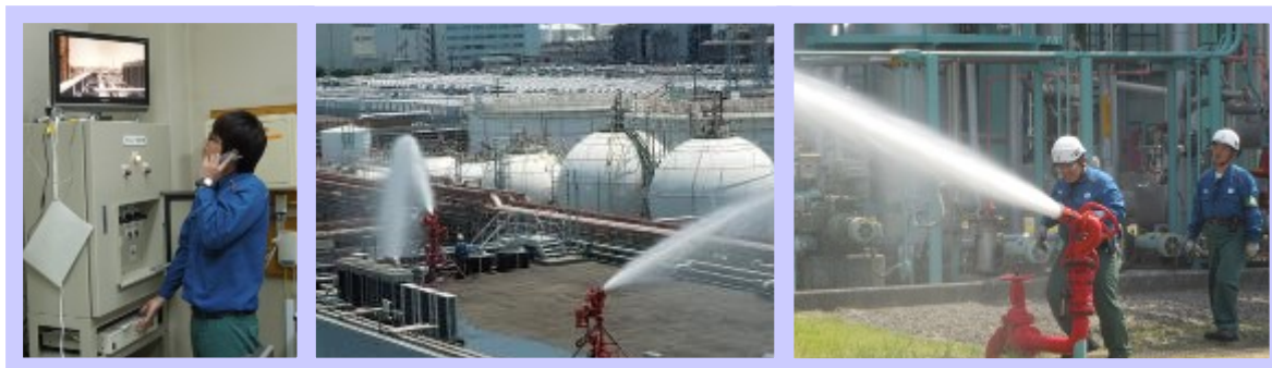
【遠隔操作で放水銃を操作する様子とその放水する様子】
