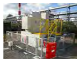
非常用発電設備
