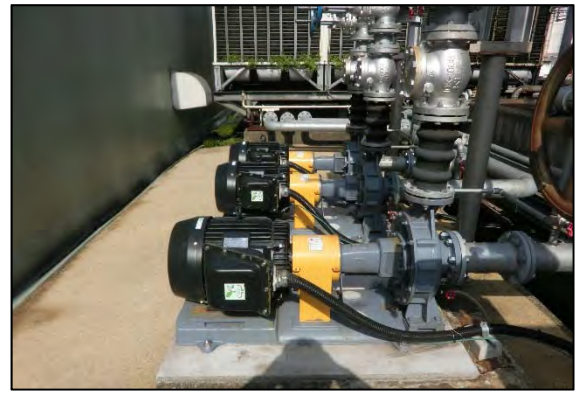
高効率モーターの冷却水ポンプ
