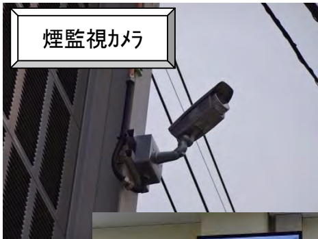
写真2. 臭気、煙監視システム
