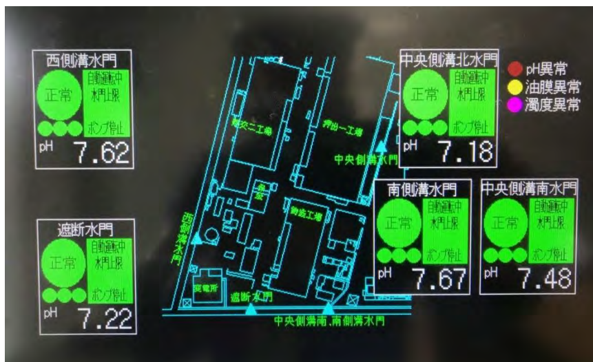
写真2. 排水監視モニター
