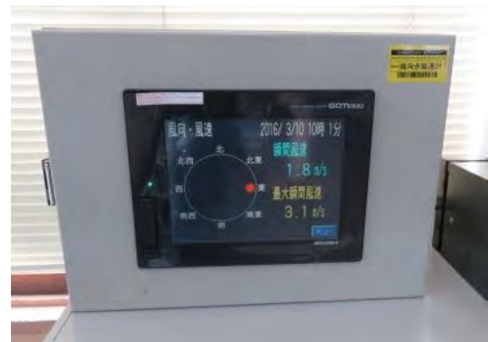
風向風速監視モニター
