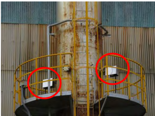
溶解炉煙突の黒煙センサー
