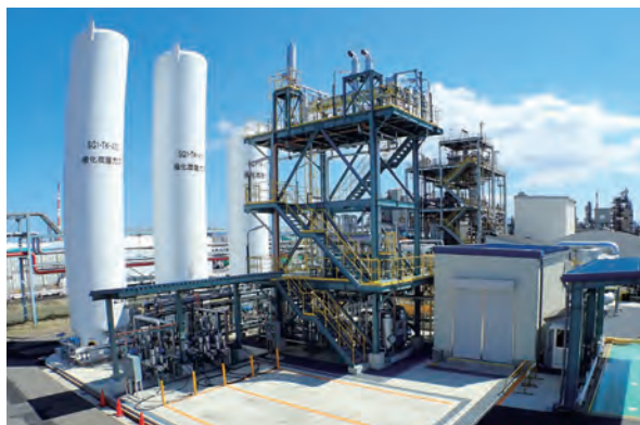
液化炭酸ガス生産設備
