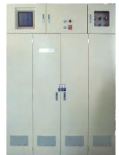
PFC排ガス処理装置
