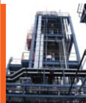
エッチングガスC 4 F 6 製造設備
