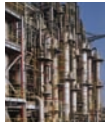
「ショウブレン®」製造プラント
