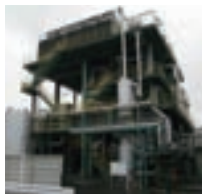
液化炭酸ガス製造プラント
